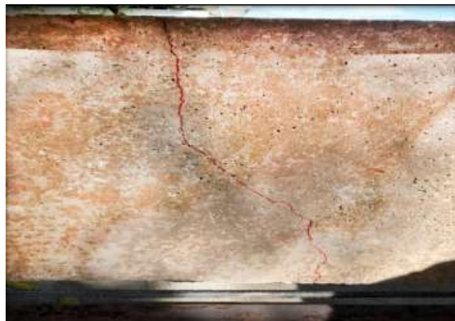
Fig. 13 Fisura de la losa Fuente: (Ciriano Marante, 2019)
