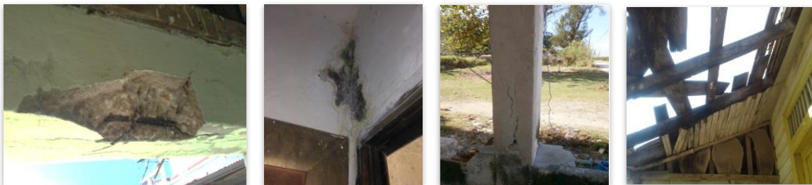
Fig. 1 Evidencias de principales patologías encontradas en los inmuebles con tipologías constructivas I (Hormigón), II (Mampostería), III (Mampostería y Cubierta ligera) y VI(Madera), 2018-2019
