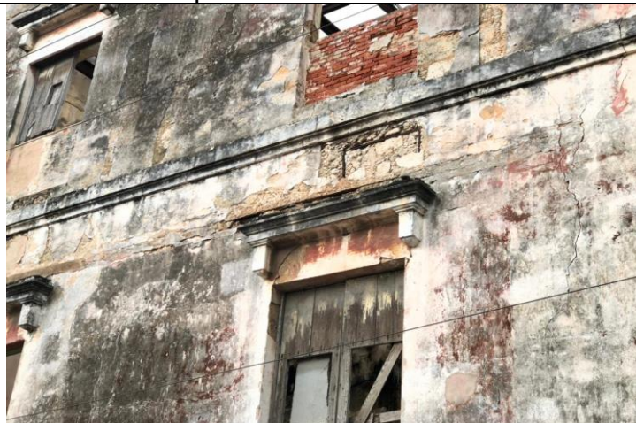
Pérdida del revoque en la fachada. Fuente: Fotos tomadas por los autores.
