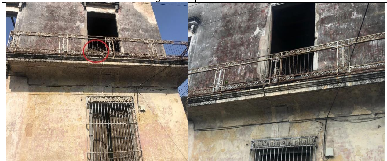
Crecimiento de vegetación parásita
