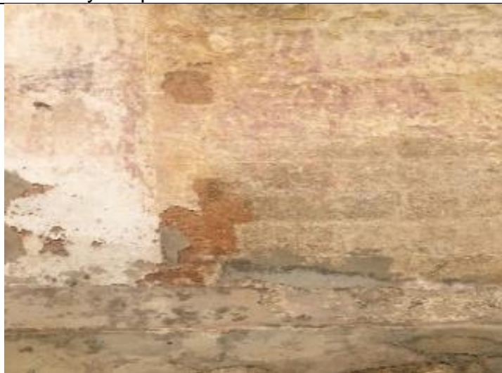
Erosión y desprendimiento del material de revestimiento Fuente: Fotos tomadas por los autores
