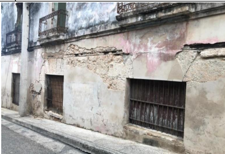
Pérdida del revestimiento Fuente: Foto tomada por los autores
