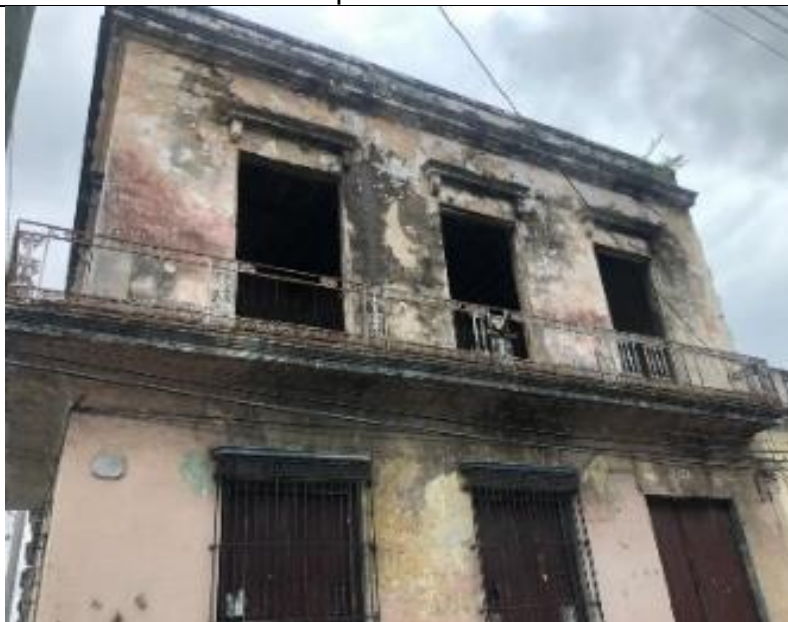
Manchas de humedad por filtración. Fuente: Fotos tomadas por los autores.
